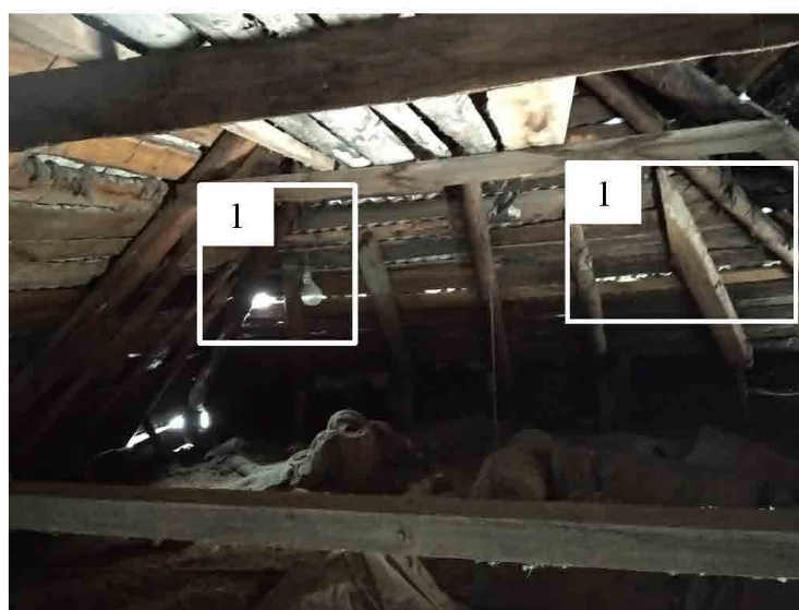
Фото 20. Крыша и кровля. Дефекты: 1 – просветы кровли.
