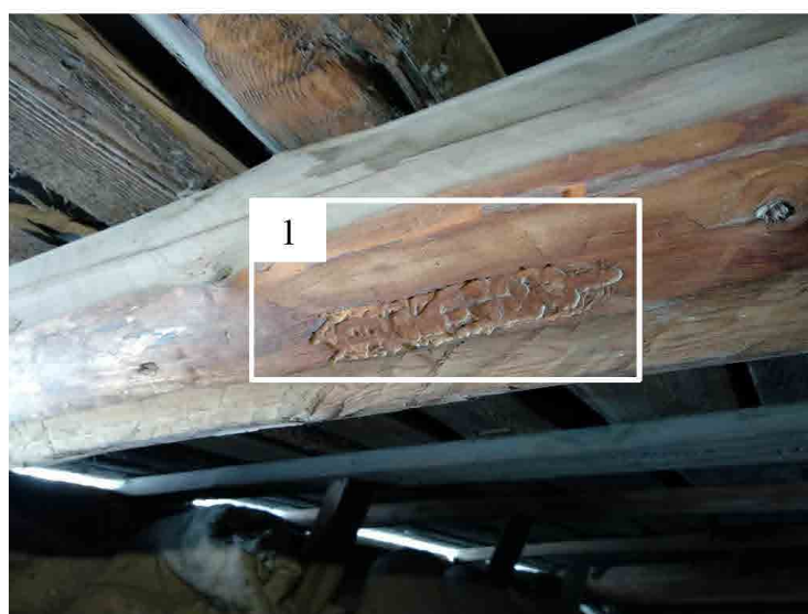
Фото 23. Крыша и кровля. Дефекты: 1 – поражение жучком.
