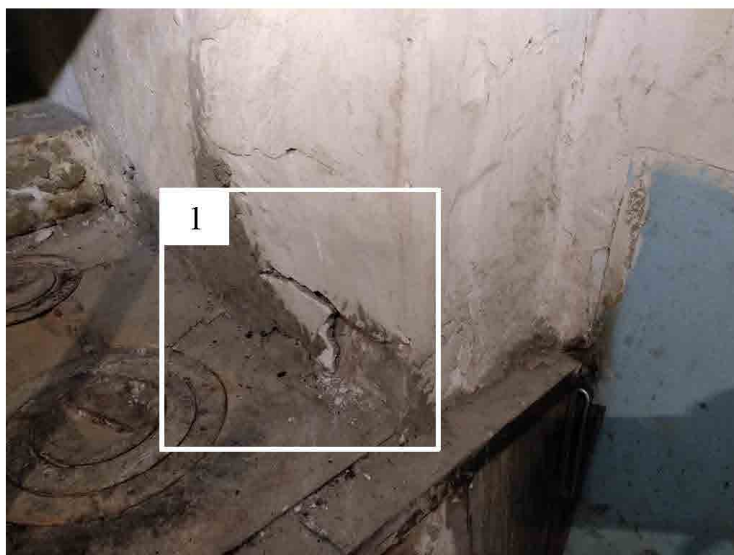
Фото 10. Печь. Дефекты: 1 – трещина.
