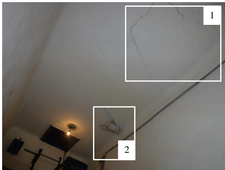
Фото 1. Чердачное перекрытие. Дефекты: 1 – отслоение отделочного слоя, трещины; 2 – следы течи.
