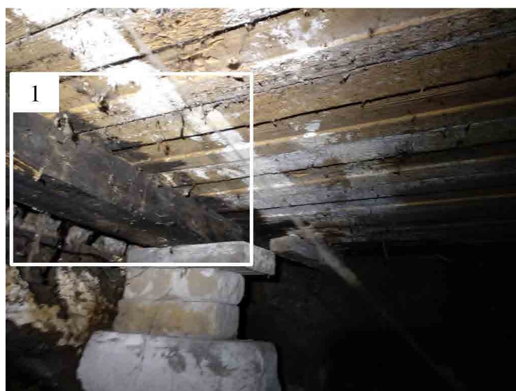
Фото 13. Пол. Дефекты: 1 – поражение гнилью.
