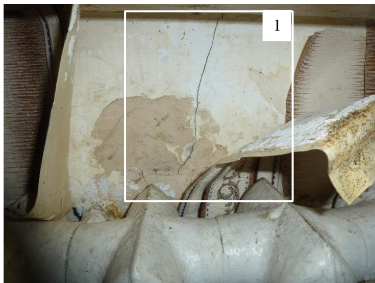
Фото 4. Наружная стена под оконным блоком. Дефекты: 1 – сквозная трещина.
