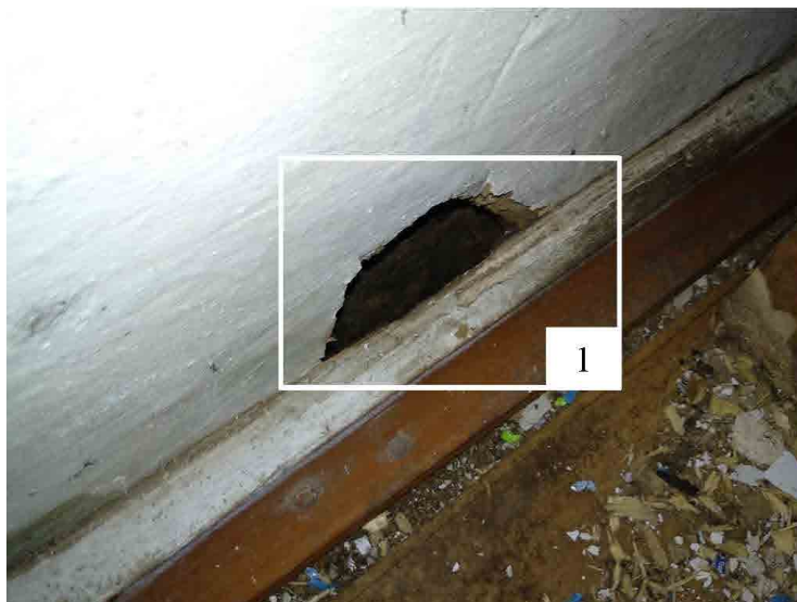
Фото 9. Сопряжение стен. Дефекты: 1 – отверстие.
