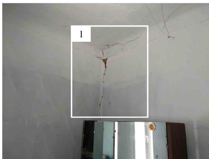
Фото 6. Сопряжение несущей стены и перегородки. Дефекты: 1 – трещина.
