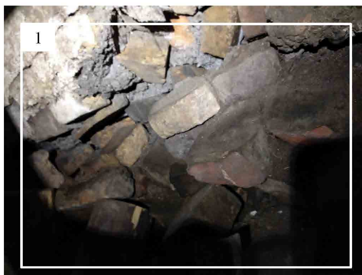
Фото 16. Фундамент. Дефекты: 1 – разрушение фундамента.
