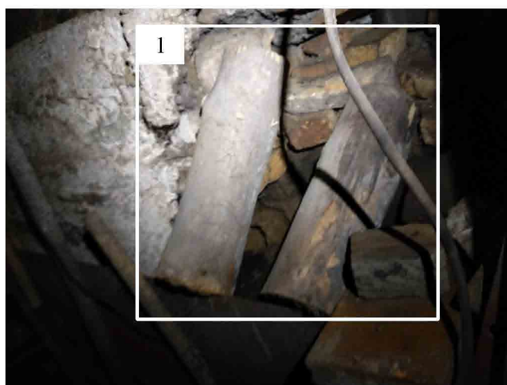
Фото 17. Фундамент. Дефекты: 1 – усиления фундамента.
