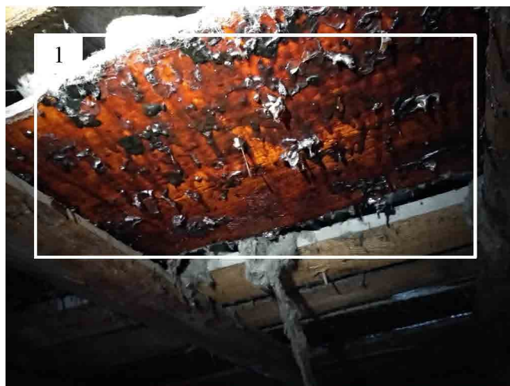
Фото 24. Крыша и кровля. Дефекты: 1 – повреждение фанерного листа.
