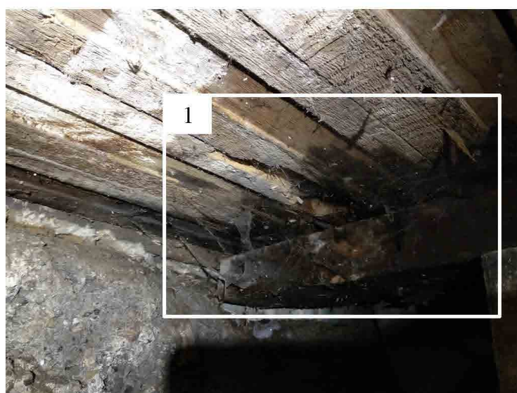
Фото 14. Пол. Дефекты: 1 – поражение гнилью.
