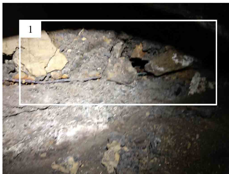
Фото 18. Фундамент. Дефекты: 1 – осыпание фундамента.
