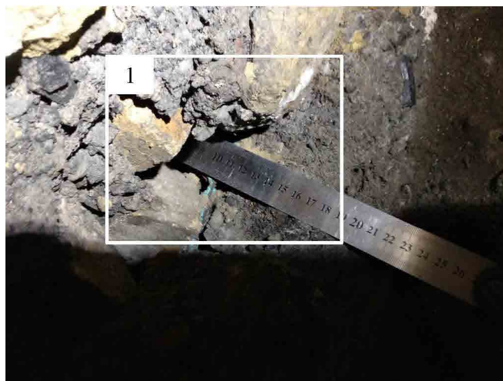
Фото 15. Фундамент. Дефекты: 1 – отверстие в фундаменте.
