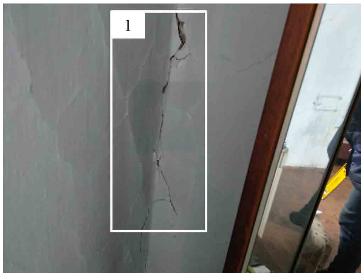
Фото 6. Сопряжение несущей стены и перегородки. Дефекты: 1 – трещина.
