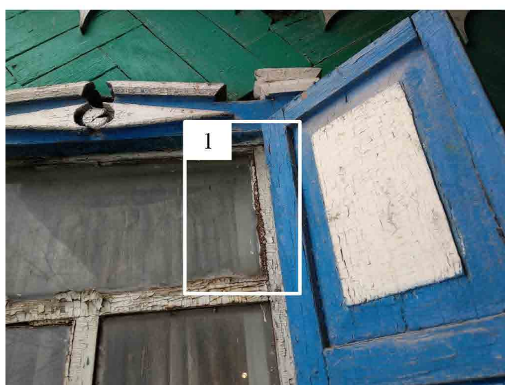
Фото 26. Окно. Дефекты: 1 - поражение гнилью.
