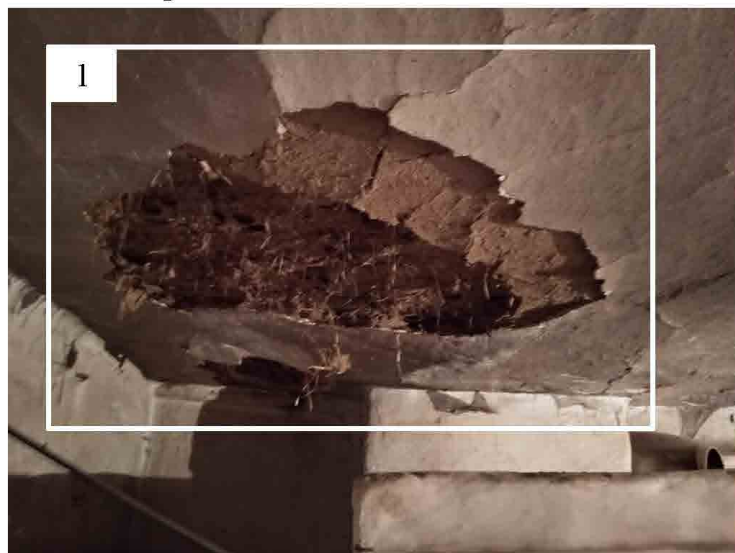
Фото 1. Чердачное перекрытие. Дефекты: 1 – отслоение отделочного слоя, трещины;
