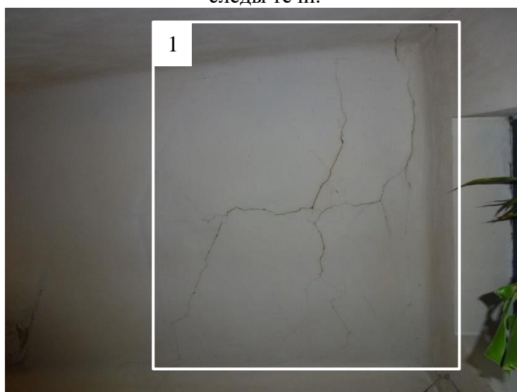
Фото 2. Чердачное перекрытие. Дефекты: 1 – отслоение отделочного слоя, трещины.
