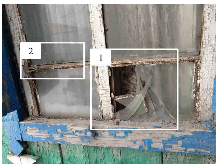
Фото 25. Окно. Дефекты: 1 – повреждение заполнения; 2- поражение гнилью.
