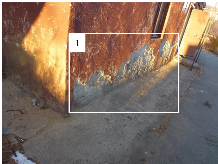
Фото 6. Наружная стена. Дефекты: 1 – отслоение отделочного слоя.
