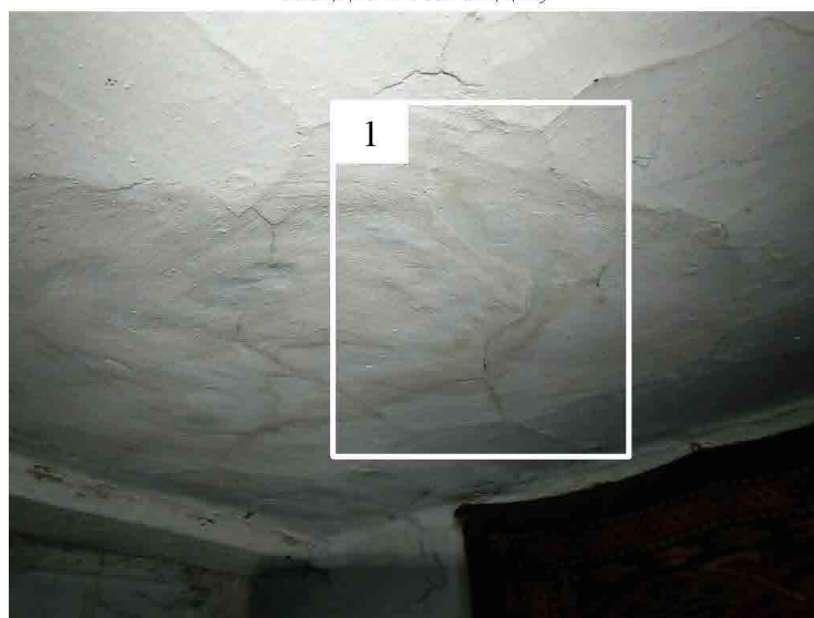
Фото 3. Наружная стена под оконным блоком. Дефекты: 1- следы течи воды;
