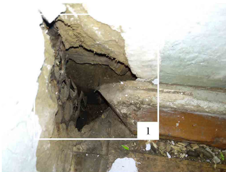
Фото 8. Сопряжение стен. Дефекты: 1 – отверстие.
