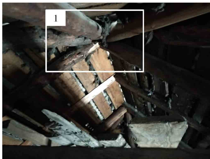
Фото 21. Крыша и кровля. Дефекты: 1 – отсутствие центральных стоек.
