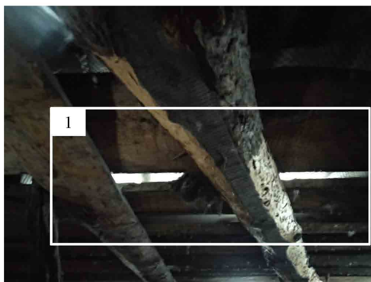
Фото 19. Крыша и кровля. Дефекты: 1 – просветы кровли.
