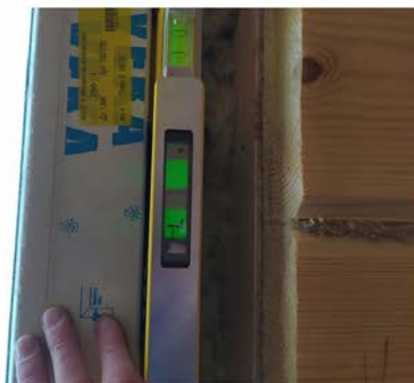
Фото 14. Отклонение оконного блока от вертикали на 1м.
