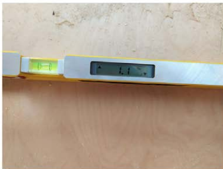
Фото 4. Отклонение напольного покрытия от заданного уклона.
