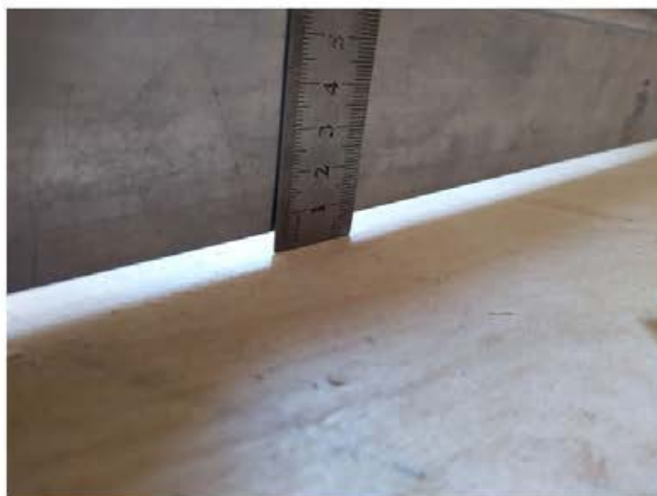
Фото 13. Неровность поверхности покрытия от на 2м.
