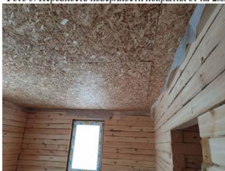
Фото 6. Вид потолка. Дефекты: 1- провисание потолочного покрытия.
