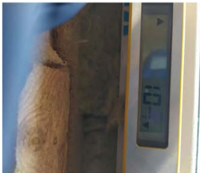
Фото 1. Отклонение оконного блока от вертикали на 1м.
