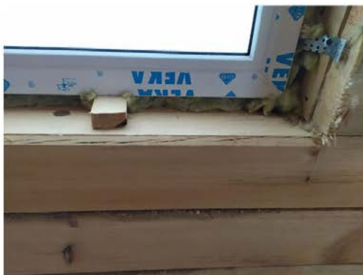
Фото 2. Открытые монтажные швы.
