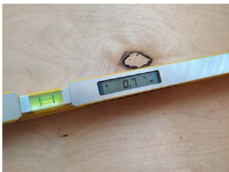
Фото 12. Отклонение напольного покрытия от заданного уклона.
