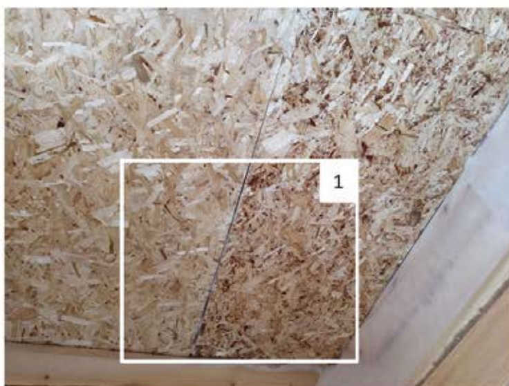
Фото 23. Вид потолка. Дефекты: 1- провисание потолочного покрытия.
