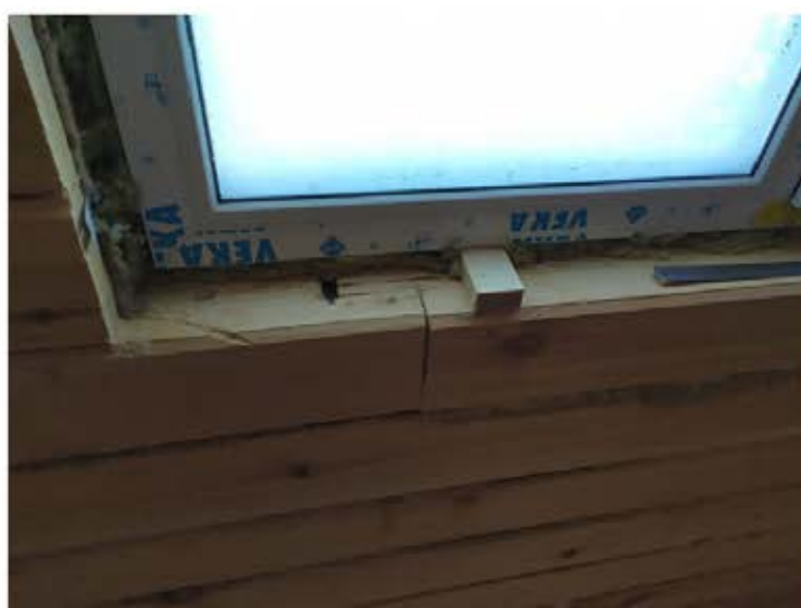
Фото 15. Открытые монтажные швы.
