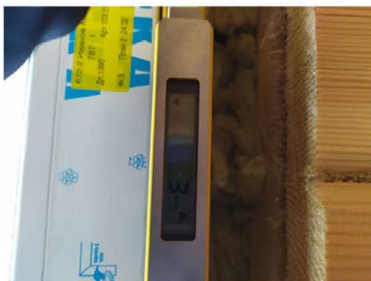
Фото 3. Отклонение оконного блока от вертикали на 1м.
