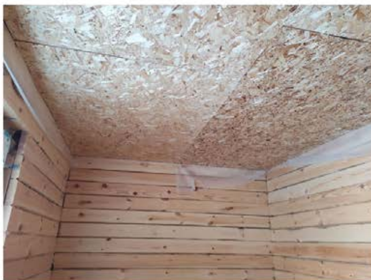
Фото 16. Вид потолка. Дефекты: 1- провисание потолочного покрытия.
