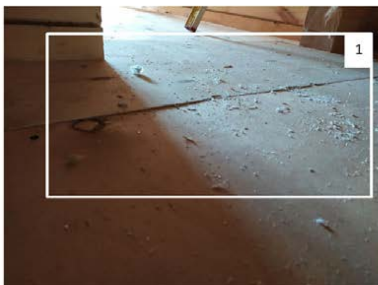
Фото 21. Вид пола. Дефекты: 1-Уступы между элементами напольного покрытия.
