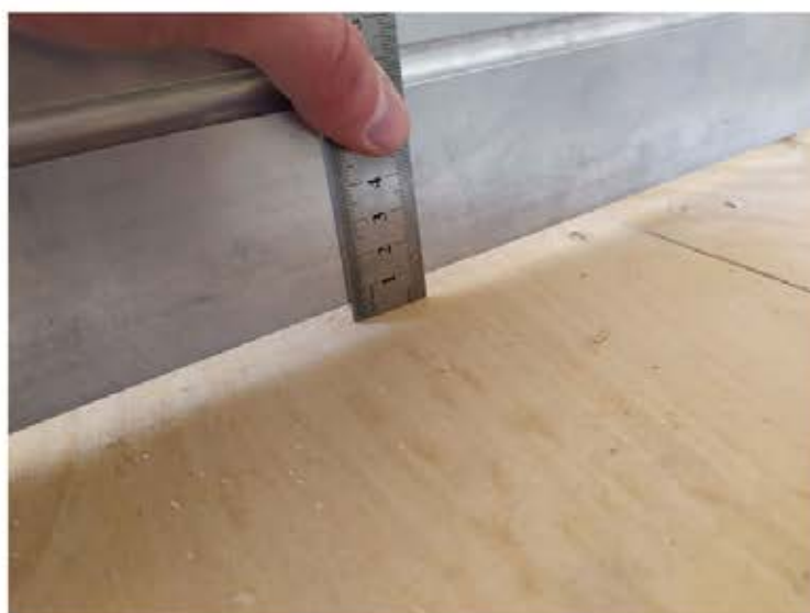
Фото 5. Неровность поверхности покрытия от на 2м.
