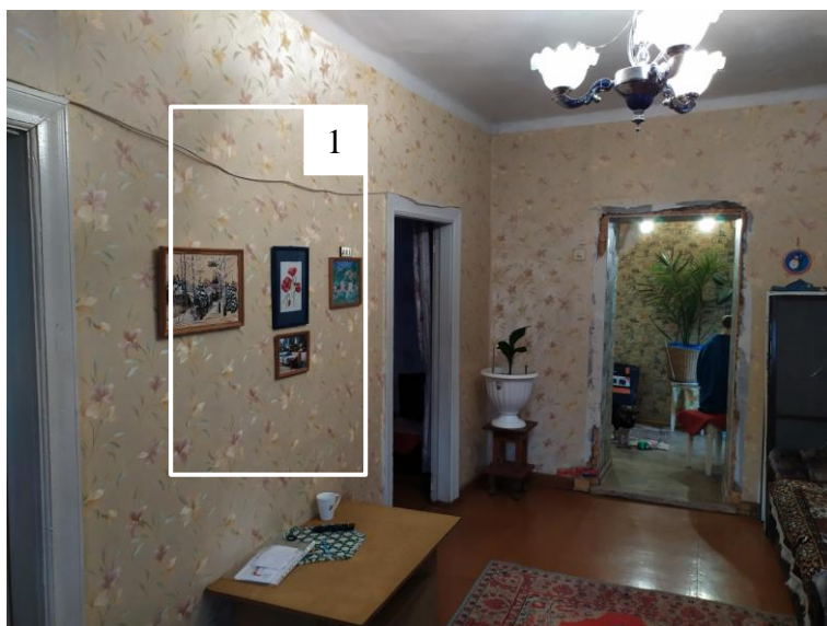
Фото 9. Фрагмент вида помещения. Дефект: 1-трещина.
