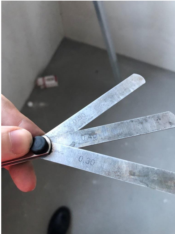
Фото 5. Фрагмент вида оконного блока. Дефект: 1 – неровность профиля створки до 1,2 мм на 1 м.
