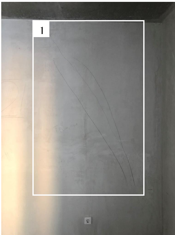
Фото 17. Фрагмент вида стены. Дефект: 1 – сквозные трещины в теле несущей перегородки.
