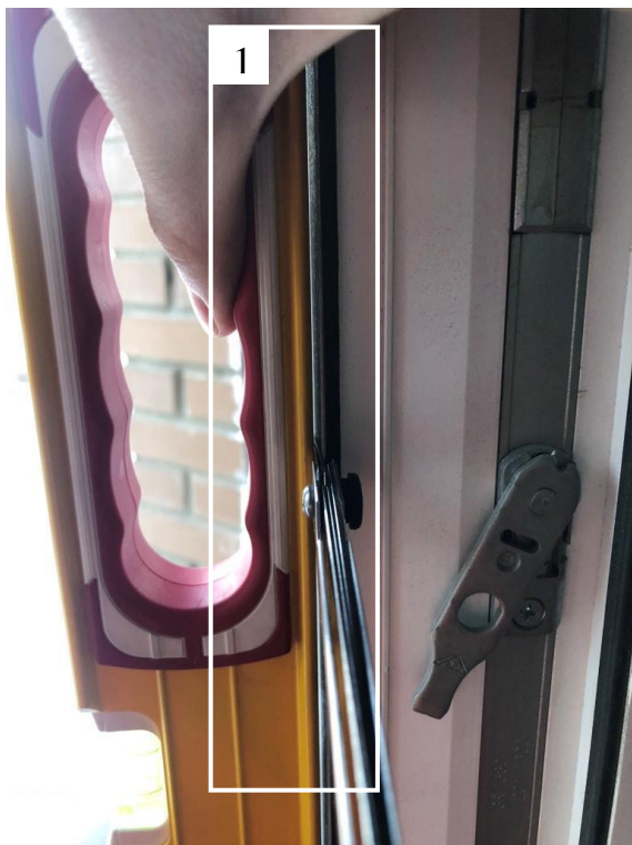
Фото 3. Фрагмент вида оконного блока. Дефект: 1 – неровность профиля створки до 1,2 мм на 1 м.
