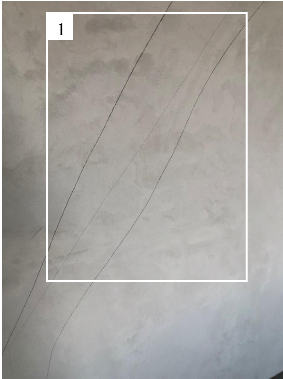
Фото 19. Фрагмент вида стены. Дефект: 1 – сквозные трещины в теле несущей перегородки.
