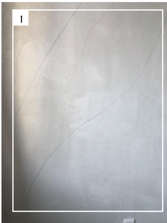
Фото 1. Фрагмент вида стены. Дефект: 1 – сквозные трещины в теле несущей перегородки.
