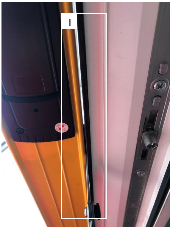
Фото 11. Фрагмент вида оконного блока. Дефект: 1 - неровность профиля створки до 1,5 мм на 1 м.
