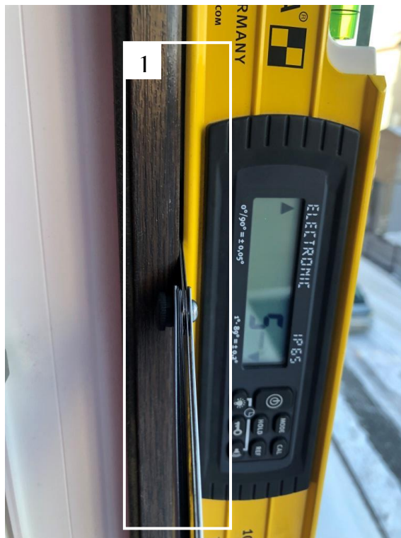
Фото 12. Фрагмент вида оконного блока. Дефект: 1 - неровность профиля створки до 1 мм на 1 м.
