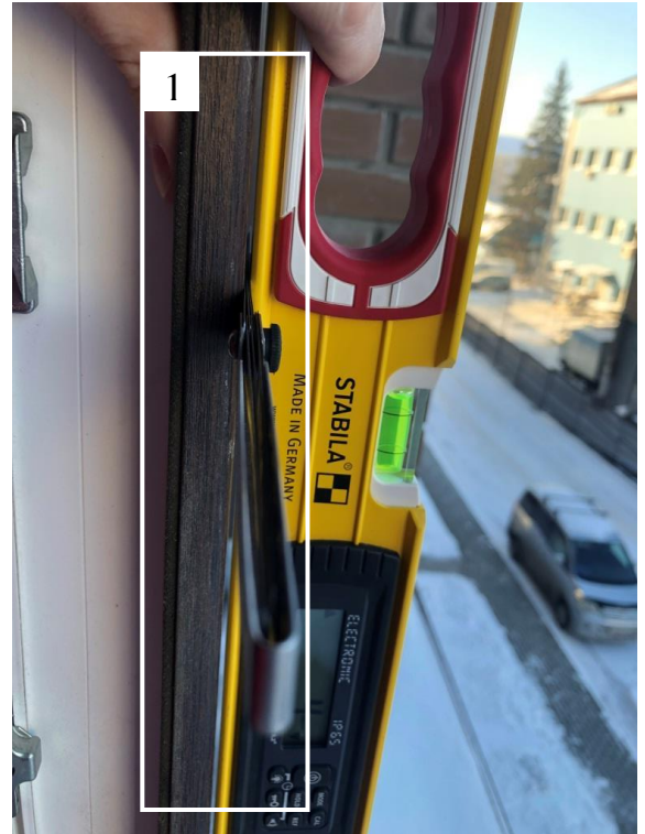
Фото 6. Фрагмент вида оконного блока. Дефект: 1 – неровность профиля створки до 1,5 мм на 1 м.
