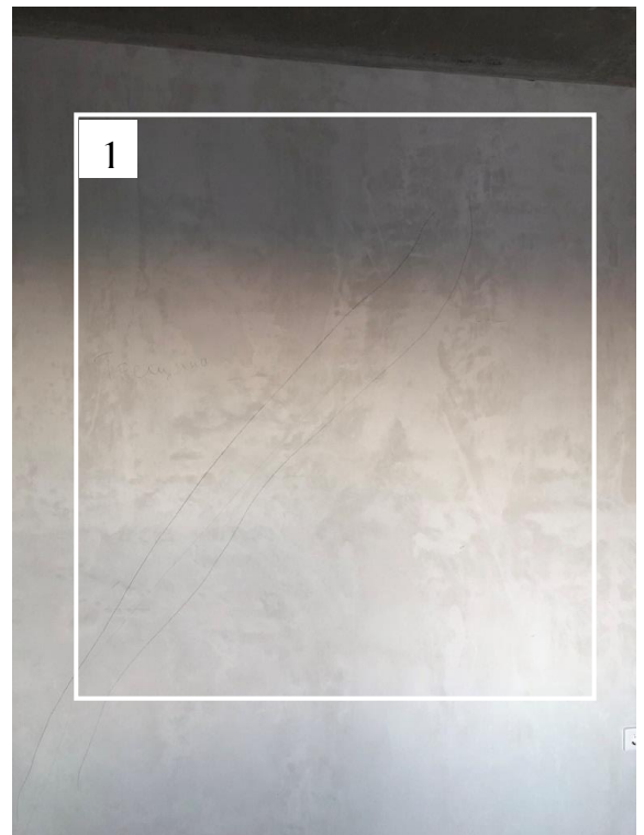
Фото 18. Фрагмент вида стены. Дефект: 1 – сквозные трещины в теле несущей перегородки.
