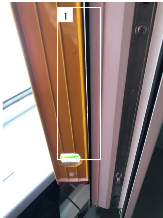
Фото 4. Фрагмент вида оконного блока. Дефект: 1 – неровность профиля створки до 1,2 мм на 1 м.
